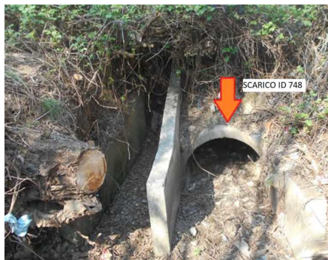
Figura 3: recapito canale scolmatore
