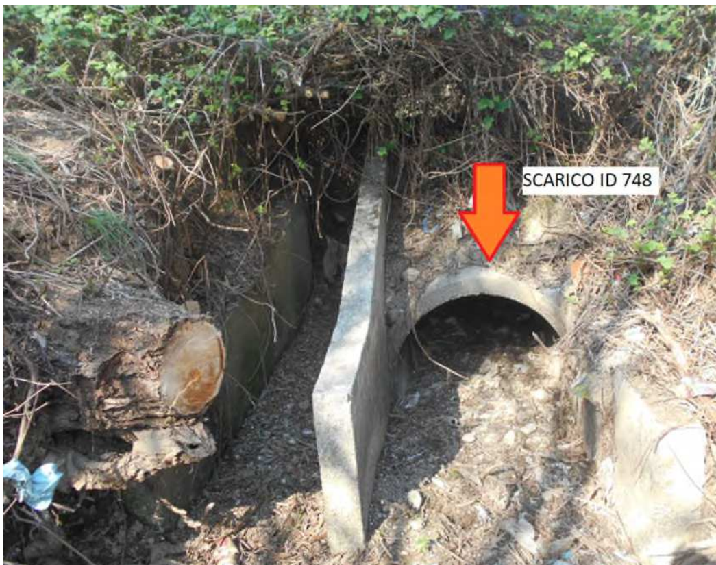
Figura 20: recapito canale scolmatore
